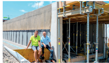
← Bürgermeister-Stellvertreter Christian Schmitzer und Bürgermeister Andreas Linhart (v.l.) begutachten den Tunnelbau von der Hamerlinggasse aus. Gemeinde Brunn/Johanna Hoblik
