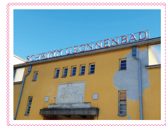
Mauerschäden an der Außenfassade
