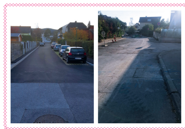
Straßen-Komplettsanierung ohne eine einzige Baumpflanzung (hier: Leinerinnengasse, Prießnitzgasse)
